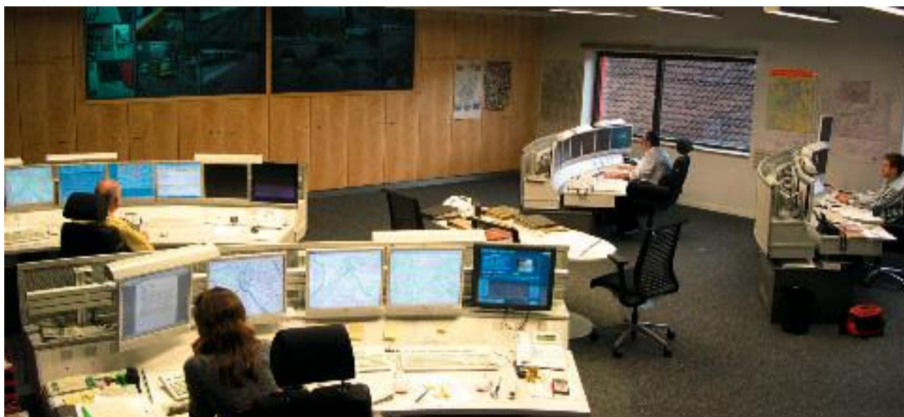
In der Integrierten Verkehrsleitzentrale Stuttgart wird der Straßenverkehr gesteuert.
